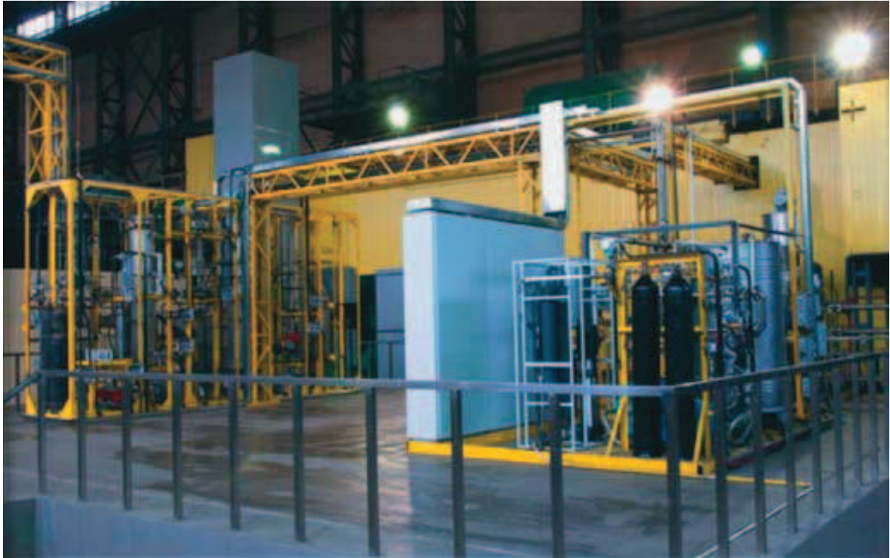
Рис. 18. Общий вид энергоустановки ЭТК-100
